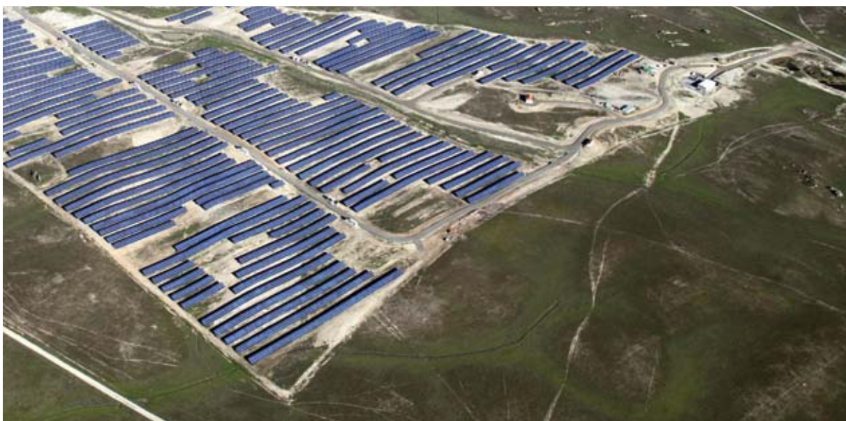
Parque solar Malpartida, courtesy: Suravia, fotografía aerea, Madrid
